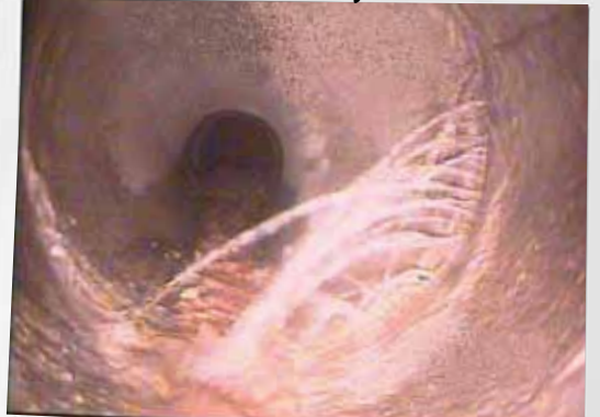
la tubería del alcantarillado a través de rajaduras y empalmes flojos
