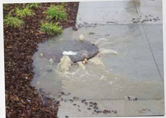
Derrame de aguas negras debido a infiltraciones
