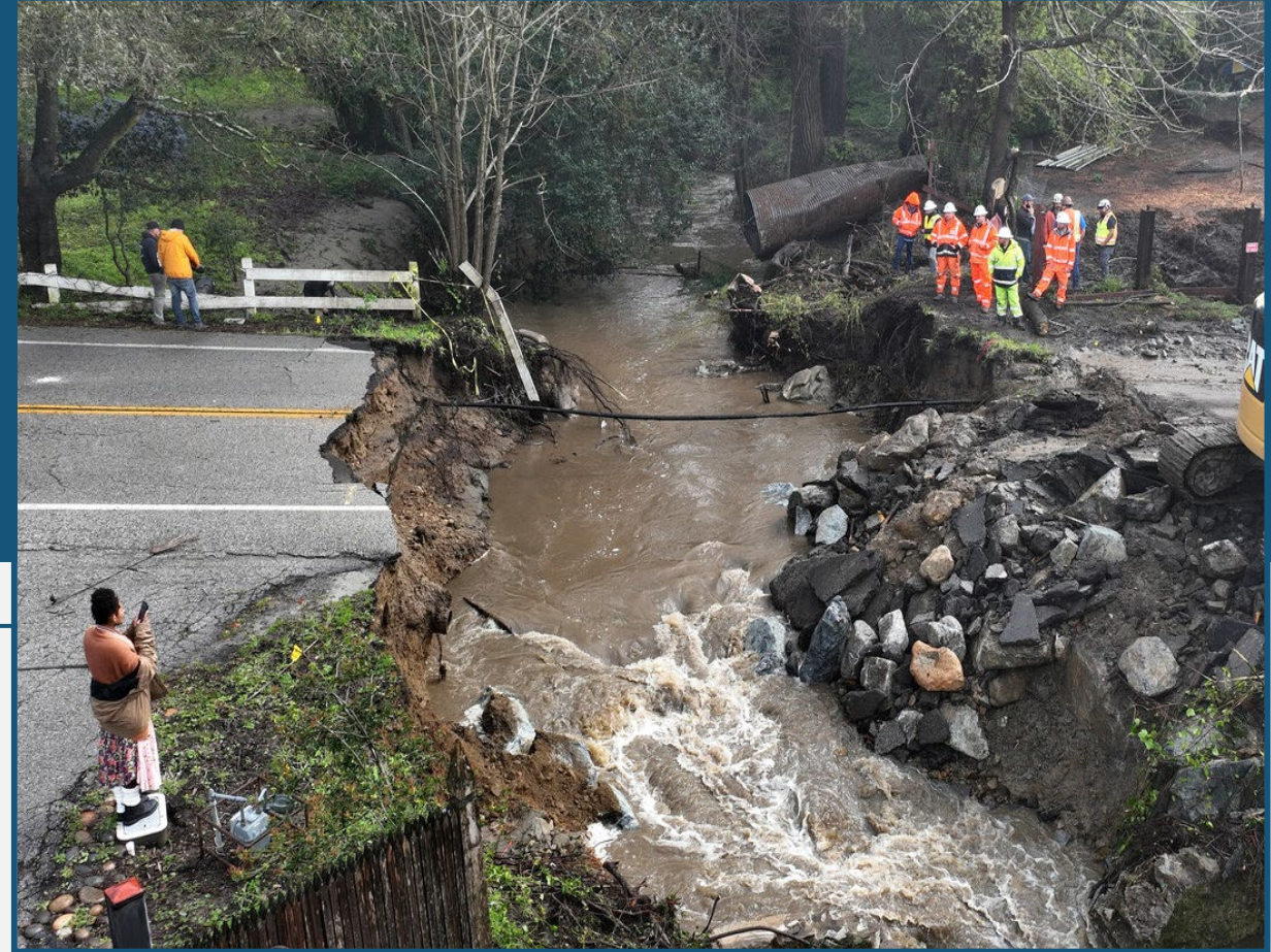
Carretera arrasada en Soquel, California, en 2023. Fuente: NPR
